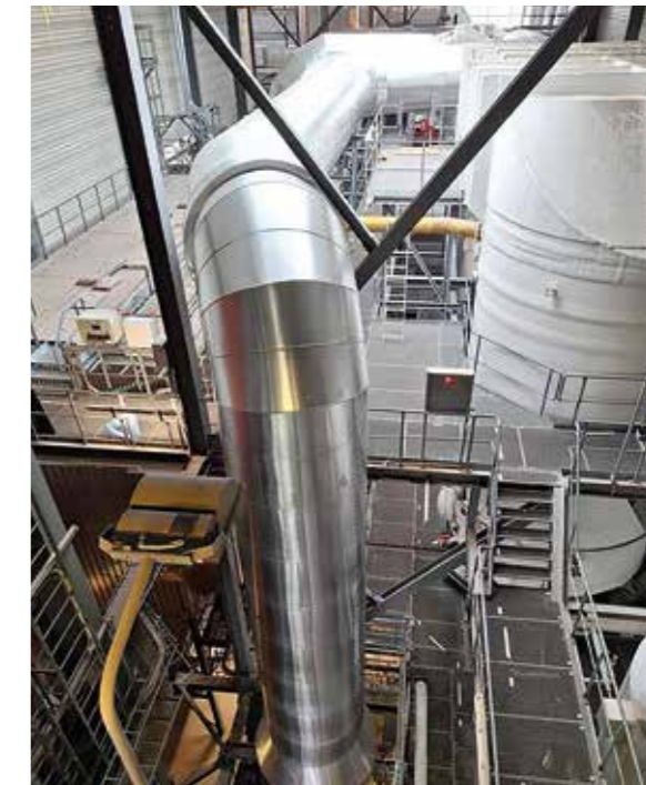
Auch die gesamten Rohrleitungen wurden von Scheuch übernommen.
