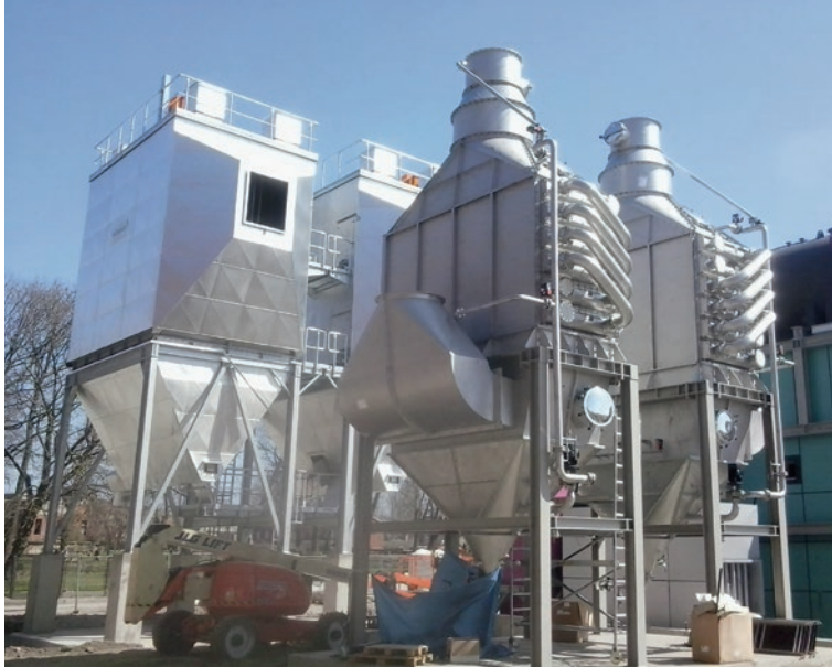
Nutzwärme für Fernwärmeversorgung Projektname: Liepaja Land: Lettland Design: ercs – TYP 01 Kesselleistung: 15 MW
