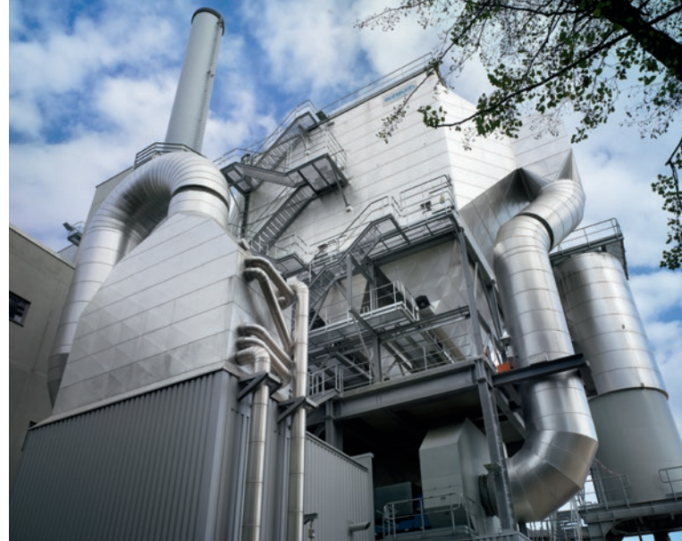
Nutzwärme für Pelletstrockner Projektname: Unterbernbach Land: Deutschland Design: ercs – TYP 01 Kesselleistung: 43,7 MW thermisch Brennstoffwassergehalt: w60
