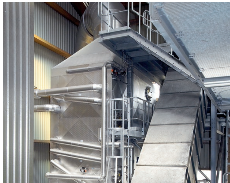
Nutzwärme für Pelletstrockner Projektname: Enerbois Land: Schweiz Design: ercs – TYP 03 Kesselleistung: 12 MW
